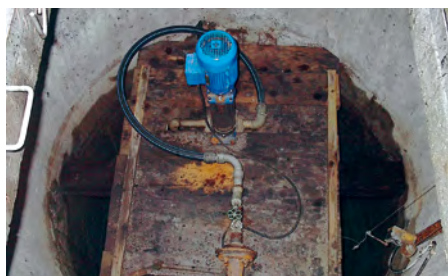
Stark verschmutzte, offene Holzabdeckung
