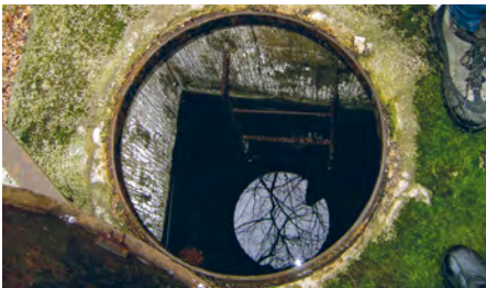
Einwuchs von Pflanzenwurzeln in den Quellschacht
