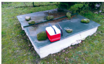
Undichte, mangelhafte Abdeckung
