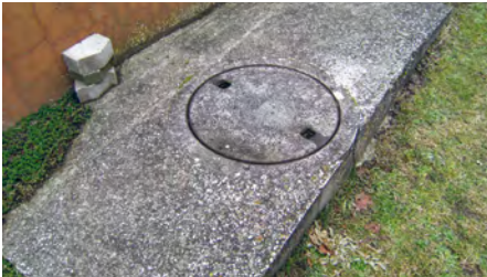
Risse in der Betoneinfassung führen zu Undichtigkeiten
