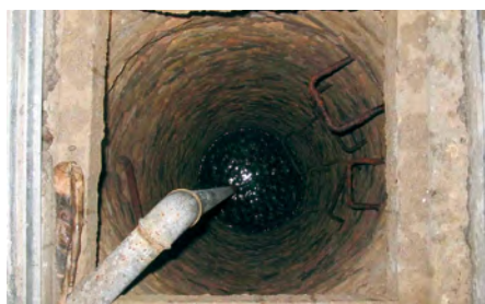
Eisenteile in Schachtbrunnen
