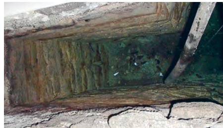
Quellschacht mit baulichen Mängeln
