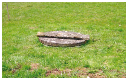
Betondeckel nicht tagwasserdicht
